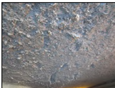
Photo N° 663 ECH-N°1 FLOCAGE -- LOCAL POUBELLE Plafonds Blanc cotonneux
